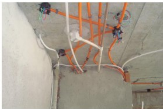
Ramais de Esgoto – 8º Pav
